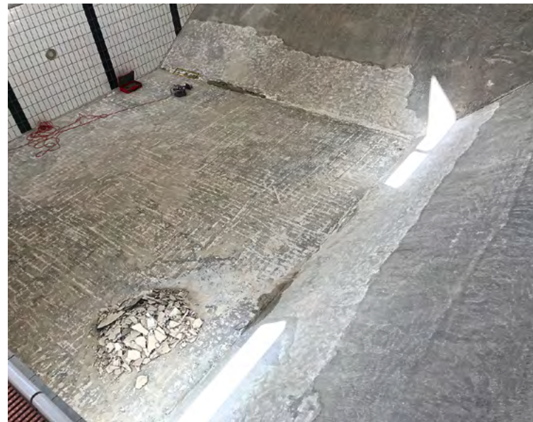
Der gesamte Untergrund und damit auch alle Fliesen mussten entfernt und dann erneuert werden.
