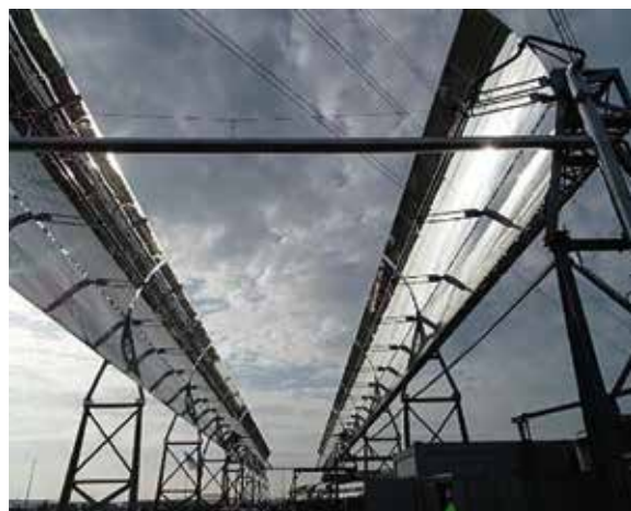
Parabolische trogcollectoren voor stoomopwekking in de ADPO-fabriek in België.
