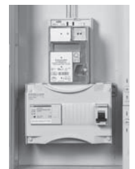
Bild 7: Zählerfeld mit BKE-MARS ZE530 (Nachrüstung)
