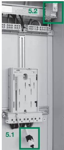
Bild 5: Zählerplatz mit Dreipunkt-Befestigung
