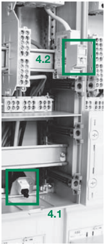
Bild 4: Zählerplatz mit BKE-I
