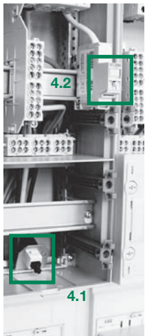
Bild 4: Zählerplatz mit BKE-I
