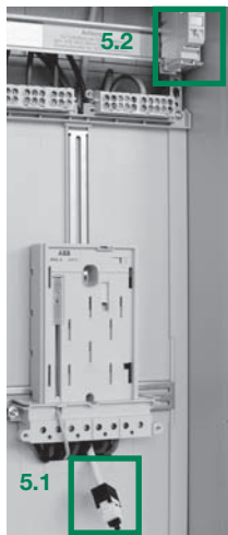
Bild 5: Zählerplatz mit Dreipunkt-Befestigung
