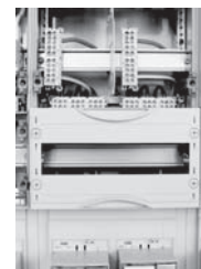
Bild 6: Zählerfeld mit BKE-I
