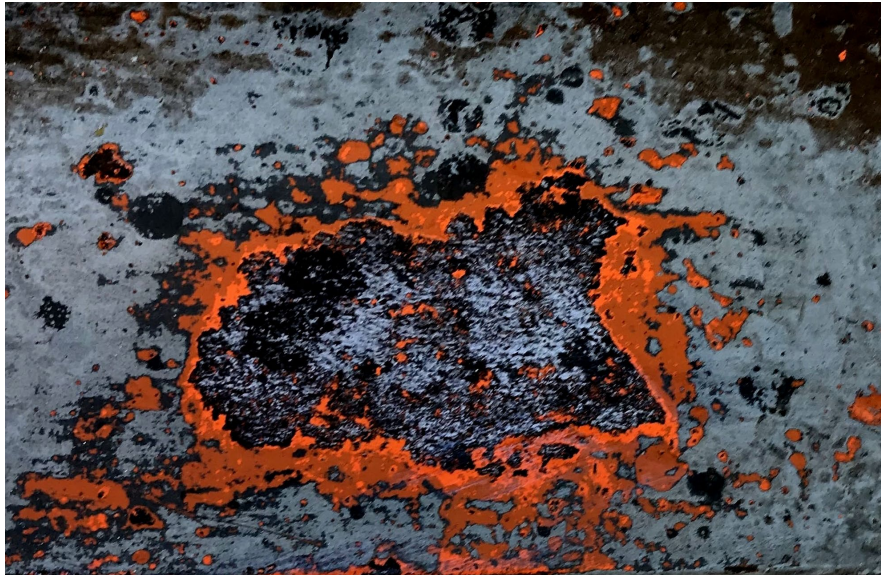
Photo 9 : Vue des anciens fonds sur un ouvrage revêtu de peinture ancienne à base de minium de Plomb © Lassarat
