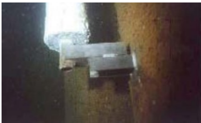
Photo 3 : Anode extérieure sur un pieu métallique © Grimaldi
