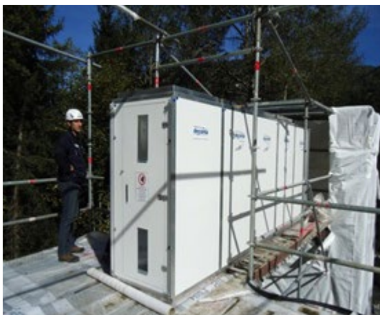
Photo 23 : Sas de décontamination
