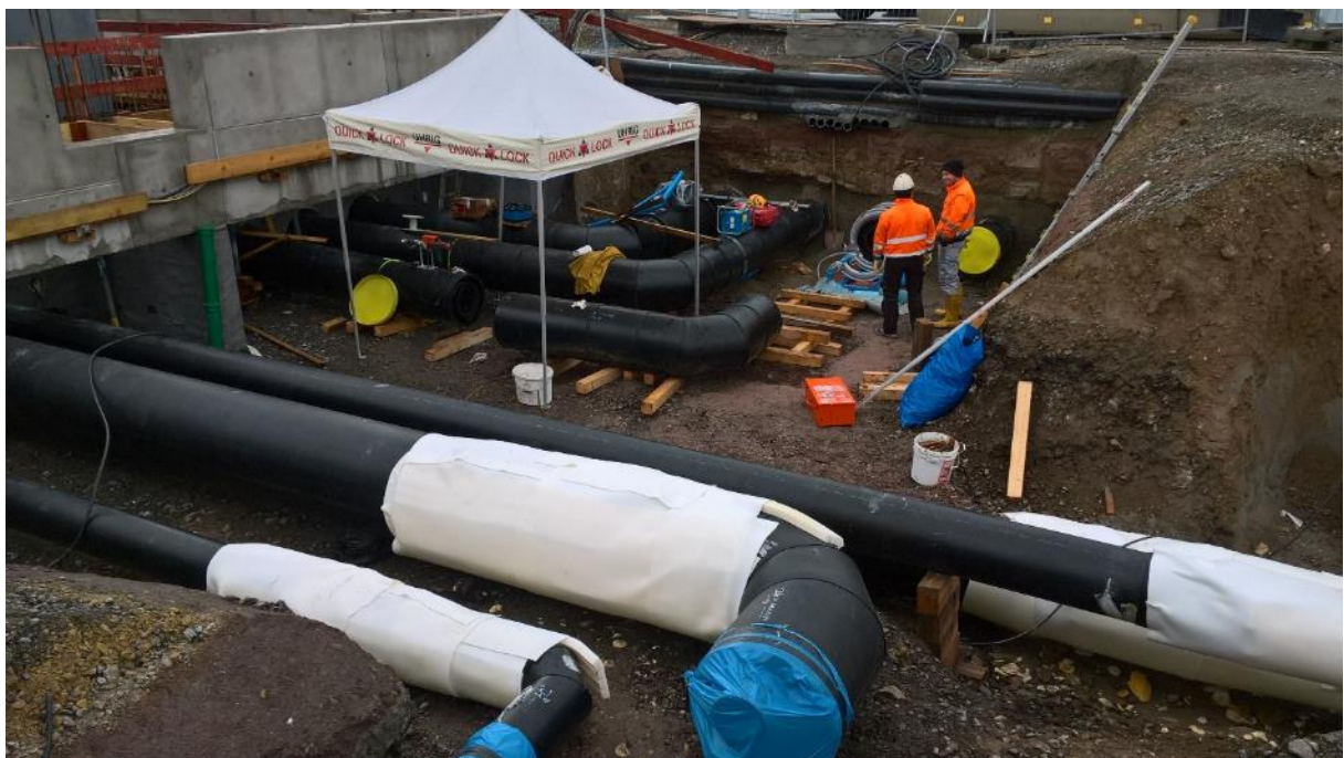
Bild 64 Anschluss der Glykol-Verbindungsleitungen
