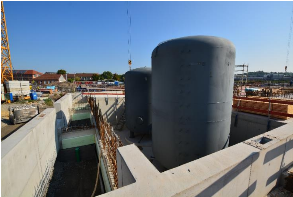
Bild 62 Energiezentrale mit Pufferspeicher
