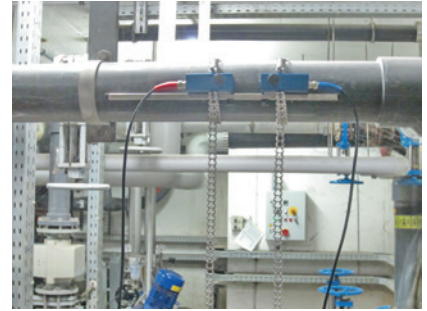
Wärmemengenmessung Stadtwerke München
