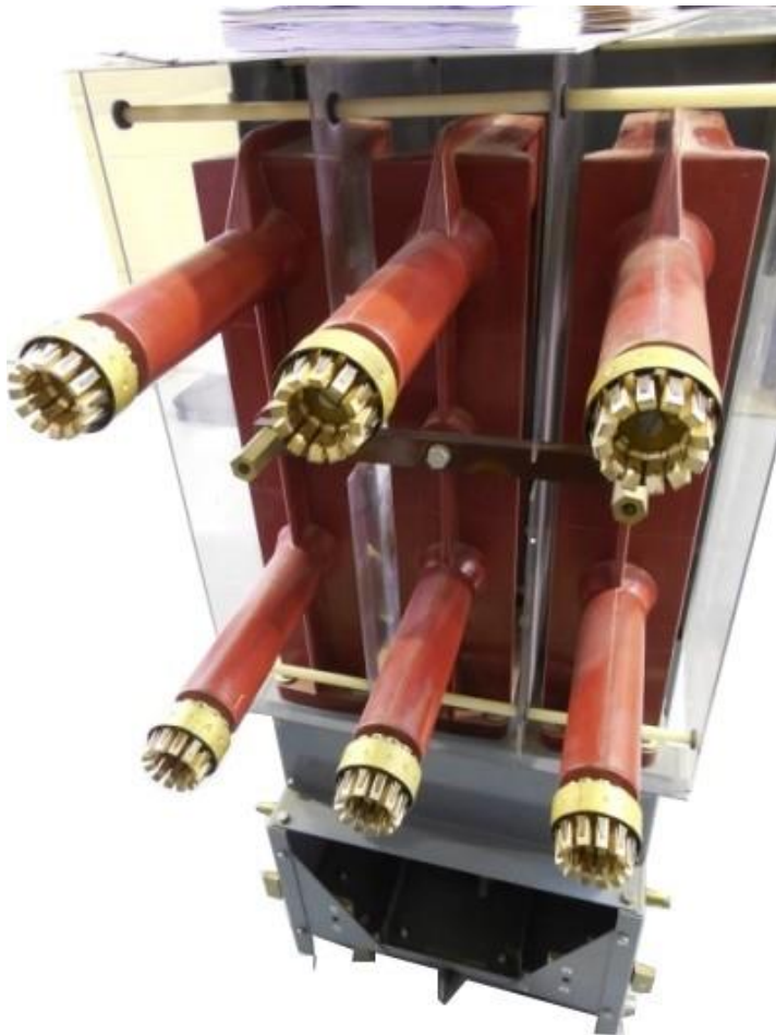
GEC Schaltwagen mit HMX Vakuum-LS GEC-switch truck with HMX VCB
