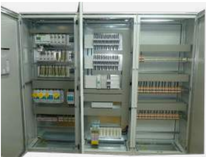
Zentralbatterieanlage mit Rangierverteiler für Unterstationen.
