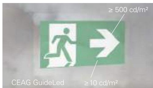
schlecht ausgeleuchtete Rettungszeichenleuchte
