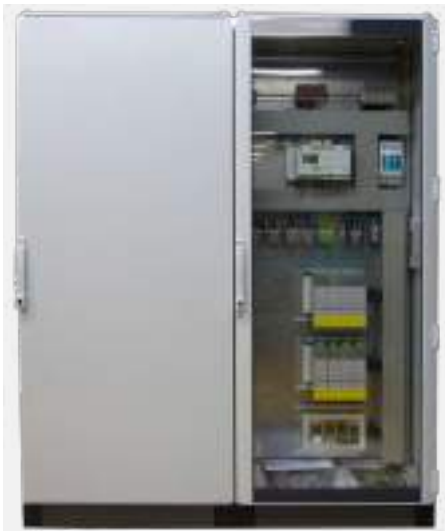
Zentralbatterieanlage mit Sicherheitsglastür.
