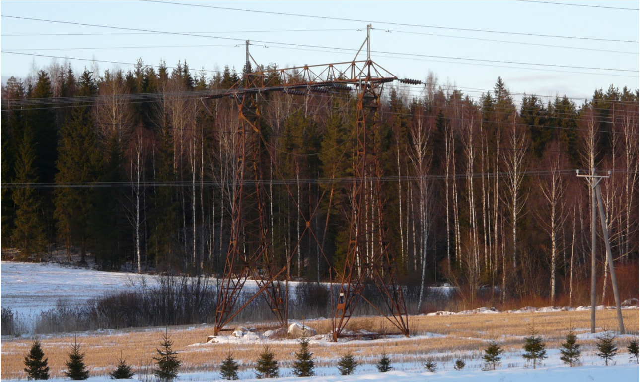
Vanha sähkölinja (Rautarouva), joka korvautuu uudella ja isommalla valtakunnan siirtolinjalla
