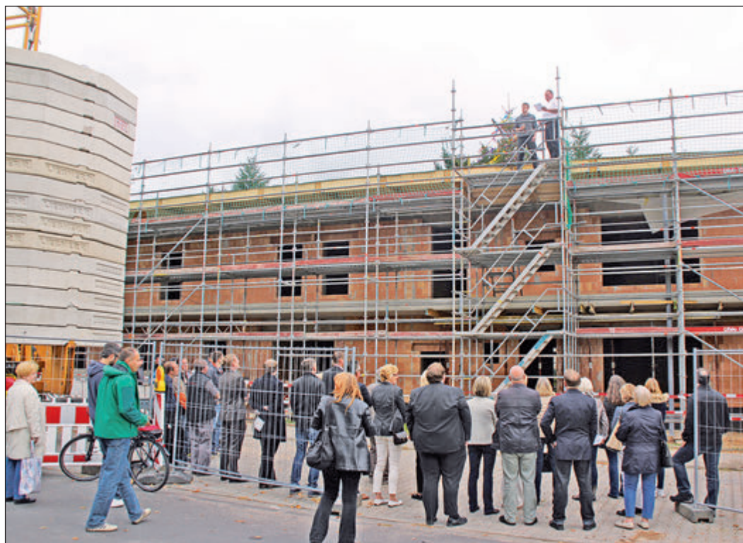
Auf dem Dach des Neubaus der städtischen Kindertagesstätte in Dornholzhausen verliert der Zimmermann den Richtspruch. Foto: Ehmler
