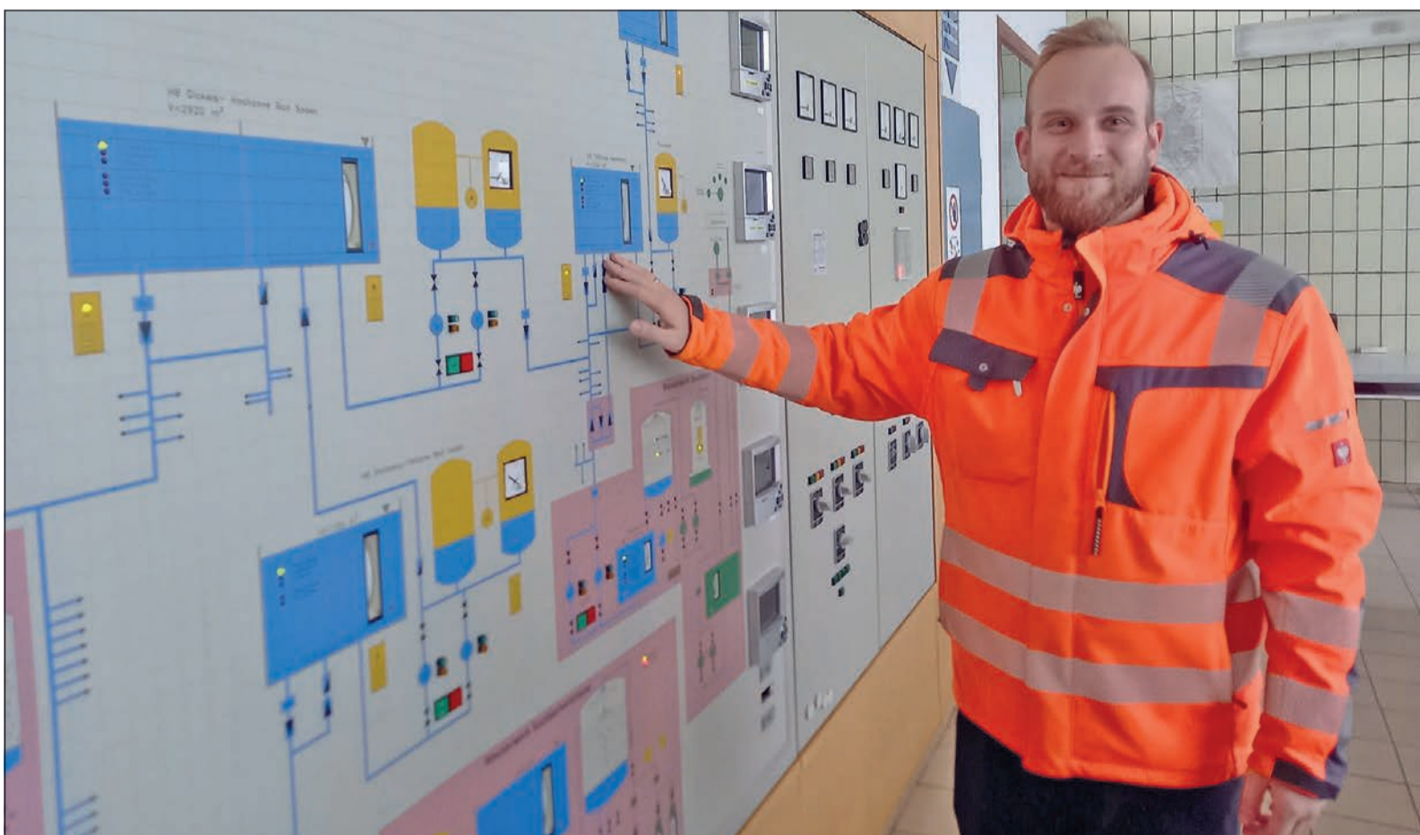
Philipp Arnoldt, Leiter des städtischen Wasserwerks in Bad Soden, an der „Mosaikwand“, der Schaltzentrale des Wasserwerks an der Sulzbacher Straße Foto: Stadt Bad Soden
