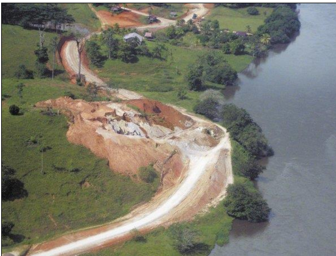
Fig. 7. Toma de imagen aérea desde el lado nicaragüense de la construcción de la carretera “Rafael Mora” a orillas del río San Juan, en territorio costarricense.
