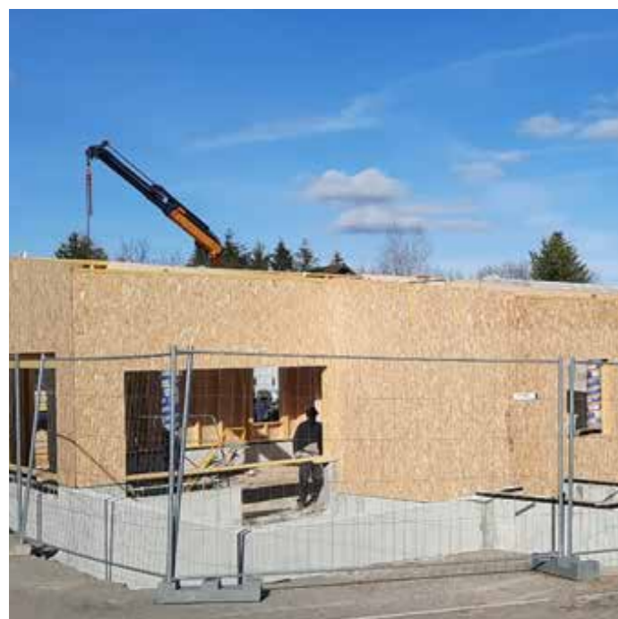
Crèche Poids de Fiore : Les travaux de la crèche ont démarré en novembre 2020.
