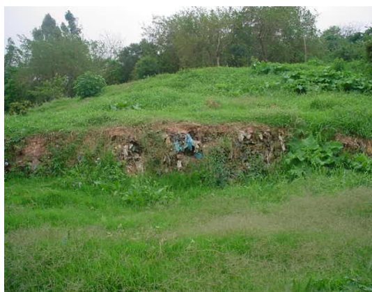
Foto 18 - Talude apresentando resíduo exposto
