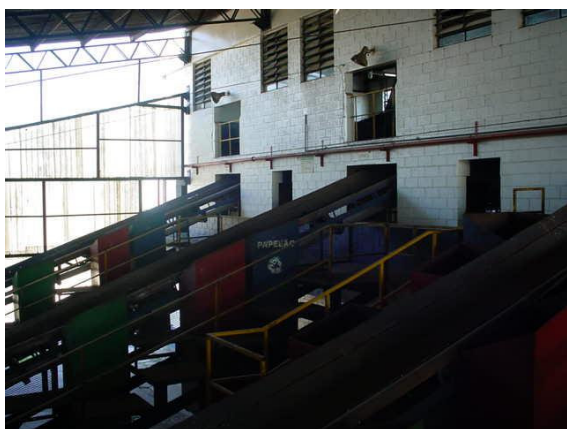
Foto 103 - Interior das instalações de separação de resíduos
