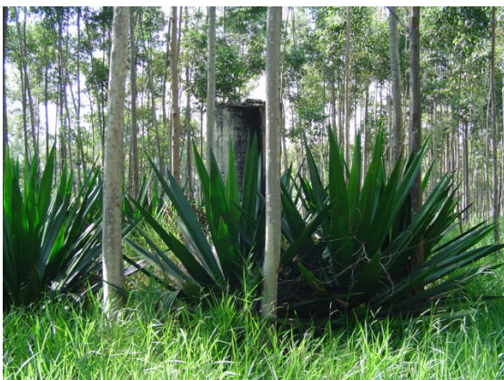
Foto 93 - Detalhe de um dreno de gás
