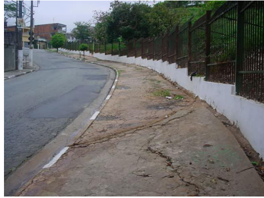
Foto 23 - Calçada com surgência eventual de percolado
