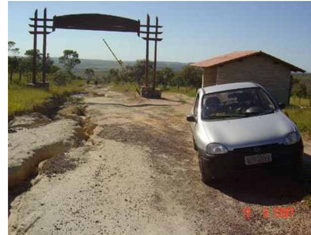
Figura 5.5 – Situação de erosão na entrada do Parque
