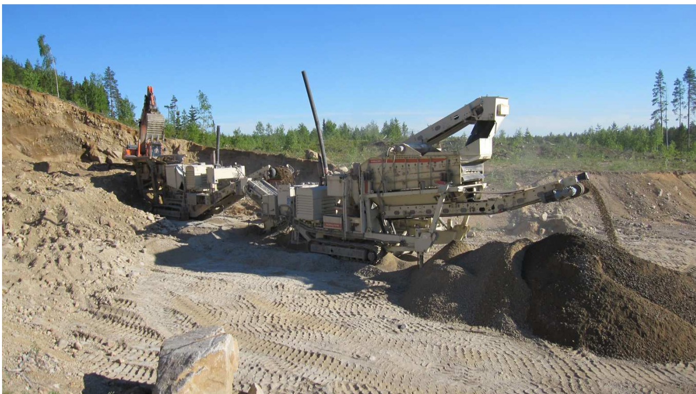
Kuva 3. Murskeen teko käynnissä. Maaperä on paikoitellen raekooltaan pientä ja hiekkaista, mutta saatu murske on riittävän hyvää pienemmille teille.
