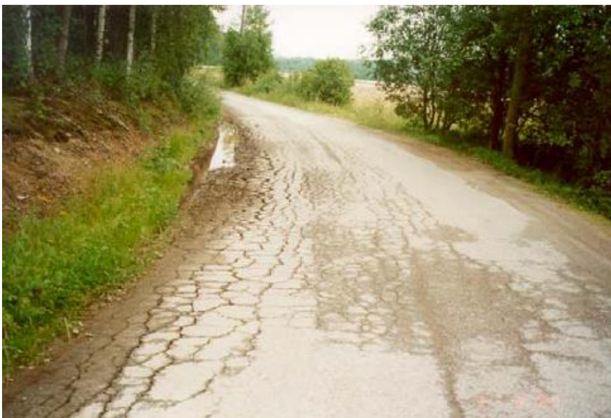
KUVA 17. Verkkohalkeama. (Päällysteiden paikkaus, 2009, 14)
