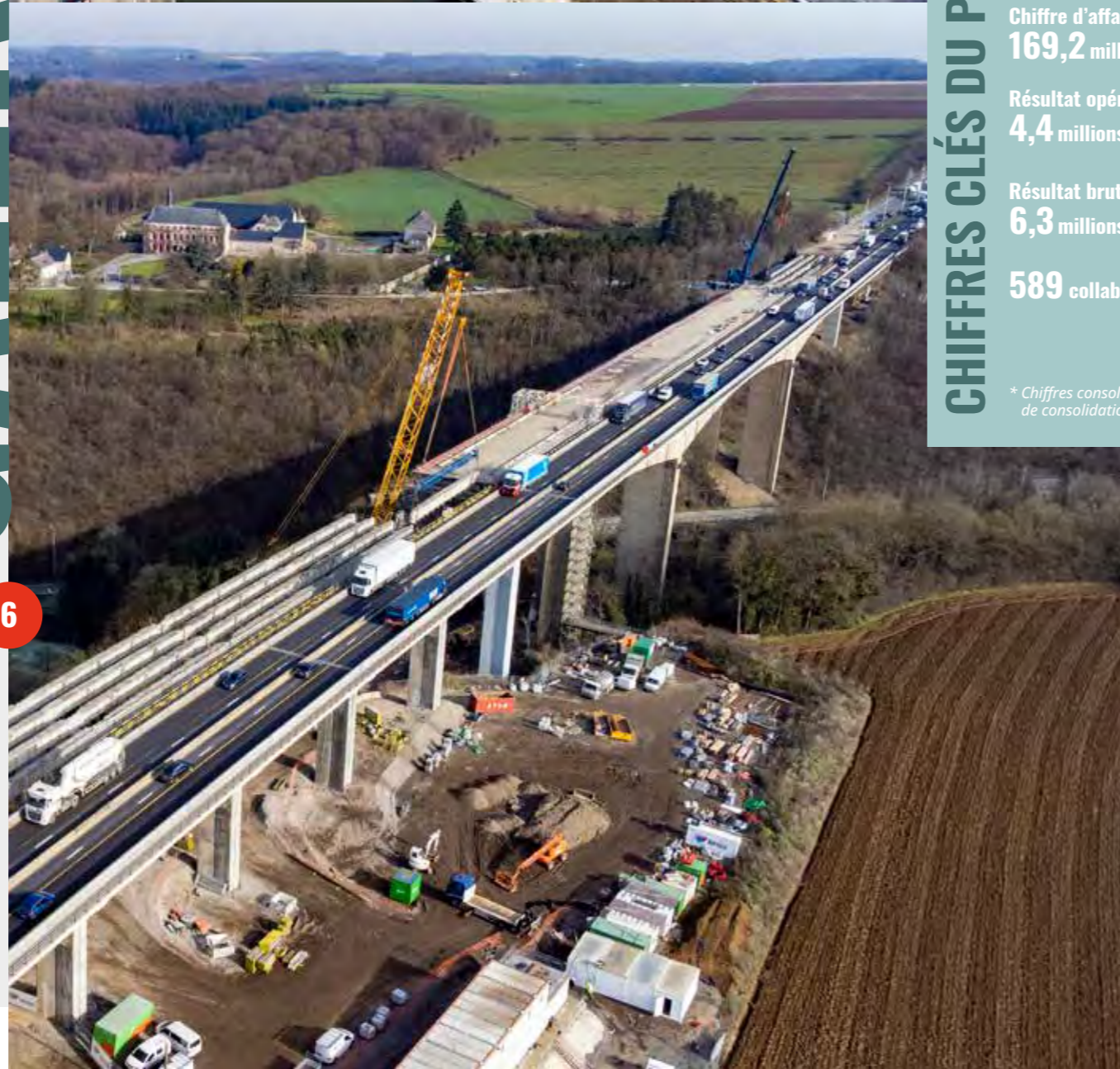
Rénovation du viaduc de Huccorgne sur l'autoroute E42/E25 entre Liège et Namur. Un ouvrage en béton précontraint sur lequel passent chaque jour 60.000 véhicules en moyenne.
