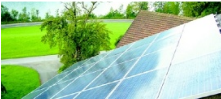
Eine Photovoltaik-Anlage ist der Start in die Energie-Unabhängigkeit.
