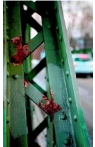
Der schlechte Zustand der Stahlkonstruktion der Eisenbahnbrücke ist unübersehbar. Fotos: Weibold
