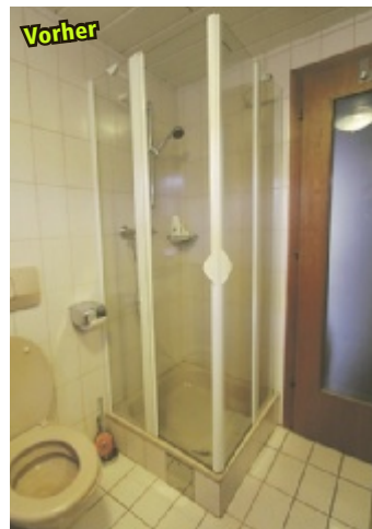
Dusche mit hohem Einstieg und rutschiger Duschtasse. Unschöne Fliesen und Silikonfugen.
