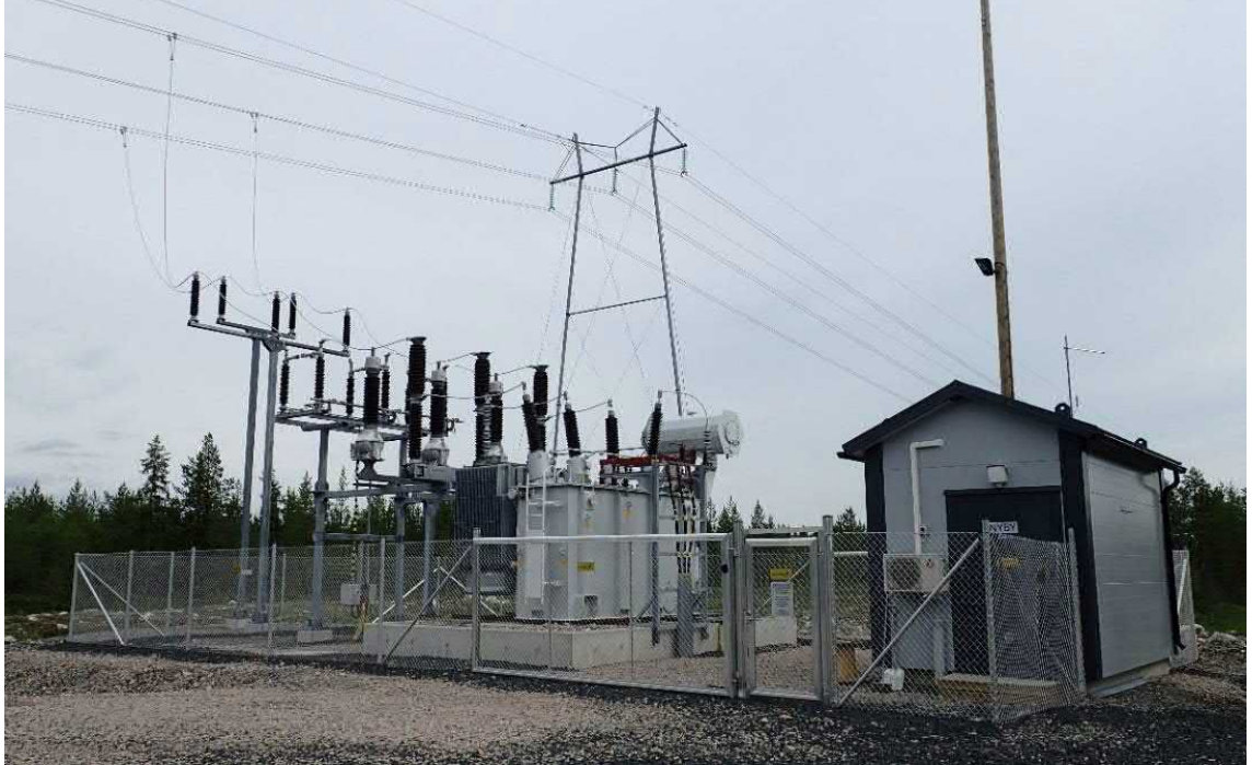
Kuva 2.16. Esimerkki tuulivoimapuiston sähköasemasta.
