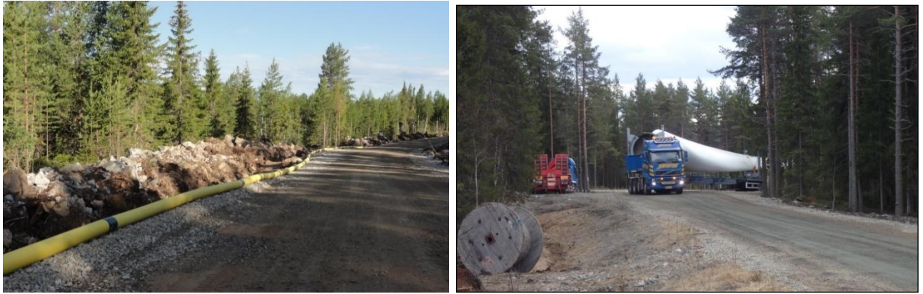
Kuva 17. (Vasemmalla) Esimerkki tuulivoimapuiston rakennus- ja huoltotiestä. Teitä käytetään muun muassa betonin, soran ja voimaloiden komponenttien kuljetuksiin sekä tuulivoimapuiston käyttövaiheessa huoltoajoihin. Maakaapeli sijoitetaan ojakaivantoon tien reuna-alueelle. (Oikealla) Tuulivoimalan osia kuljetetaan erikoiskuljetuksina. (Kuvat: FCG).
