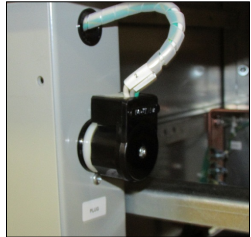
Fig. 34 Test Power Receptacle
