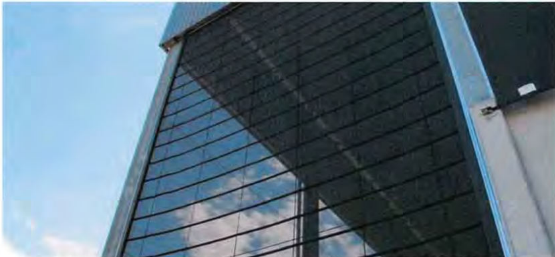
Rolltor mit Netzbespannung bei der Umladestation des Landkreises Fulda
