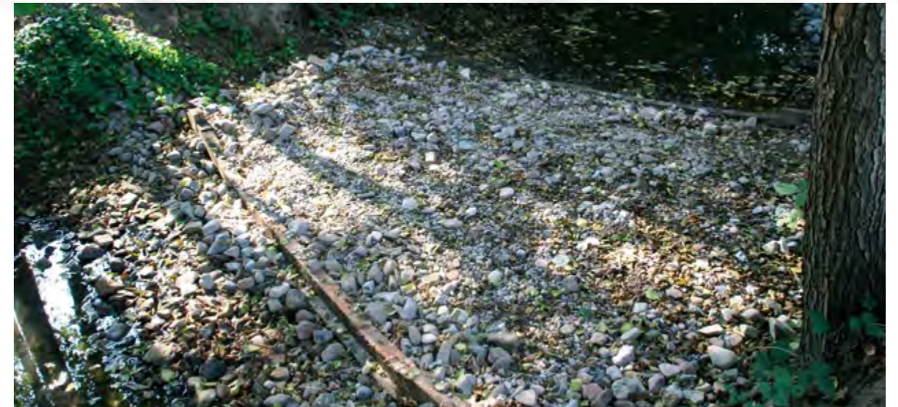
Überlaufschwelle zum Sandfang
