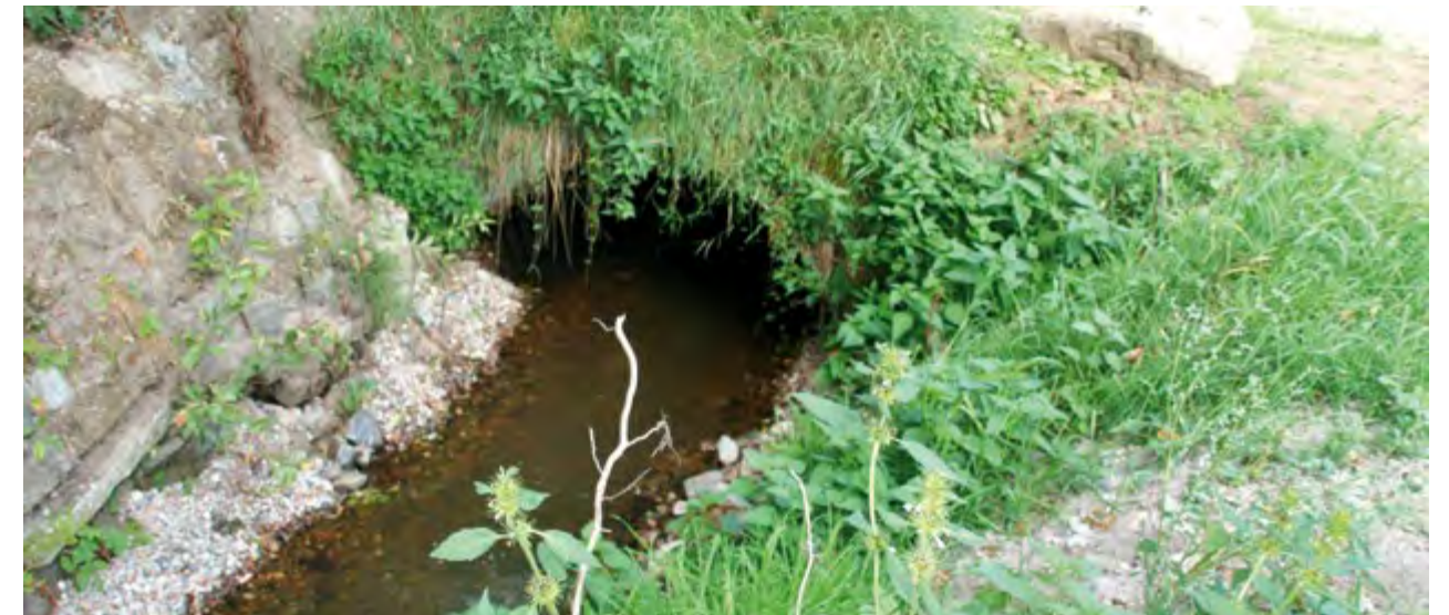
Großzügiger Hamco-Durchlass im renaturierten Gewässerlauf
