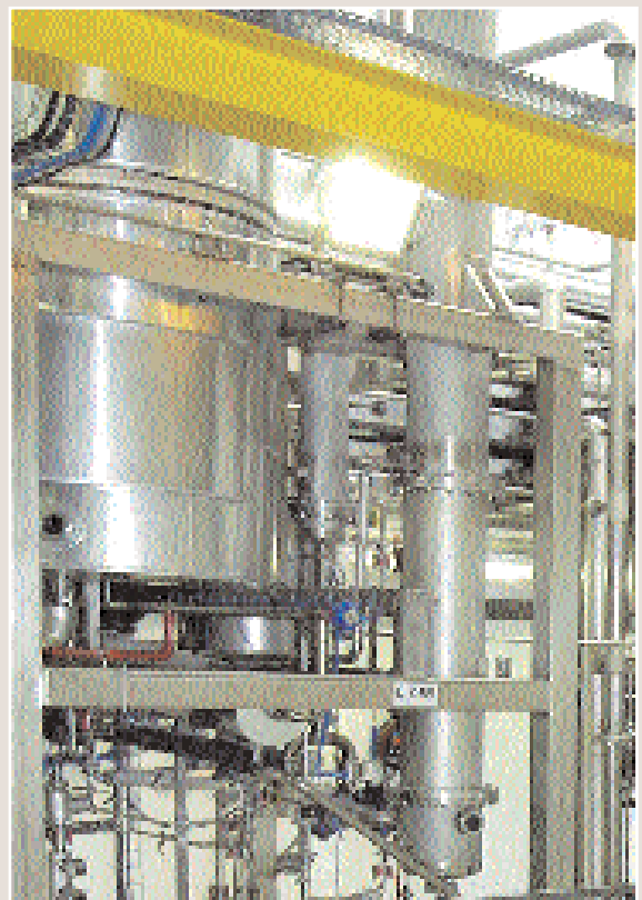
La nouvelle usine de fabrication de l'antiépileptique Keppra , à Braine l'Alleud (Belgique), dont la deuxième unité a été mise en route en 2003, utilise la technologie de la chromatographie multicolonne qui permet de réduire considérablement les déchets.
