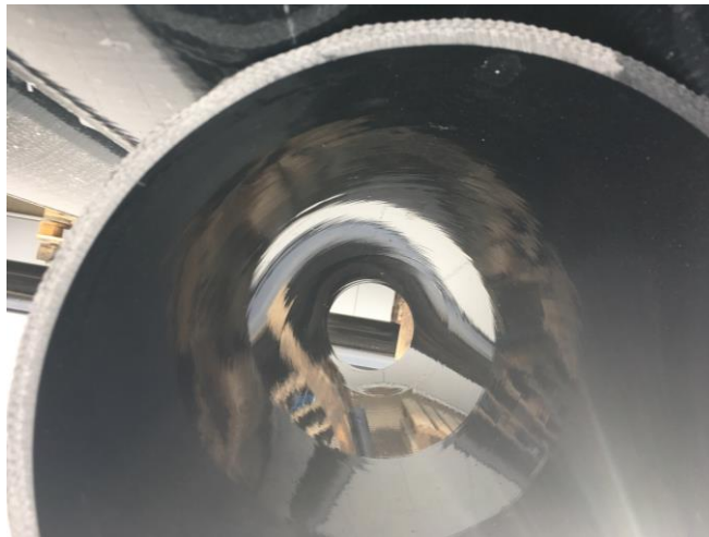
Abbildung 11: Innenansicht eines Epoxid-Rohres (24.04..2017)
