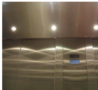
Abb. 7: Die Edelstahlverkleidung dieses Fahrstuhls zeigt ein ganzes Netzwerk von Lichtbändern, die durch die an der Decke angebrachten Halogenleuchten hervorgerufen werden.
