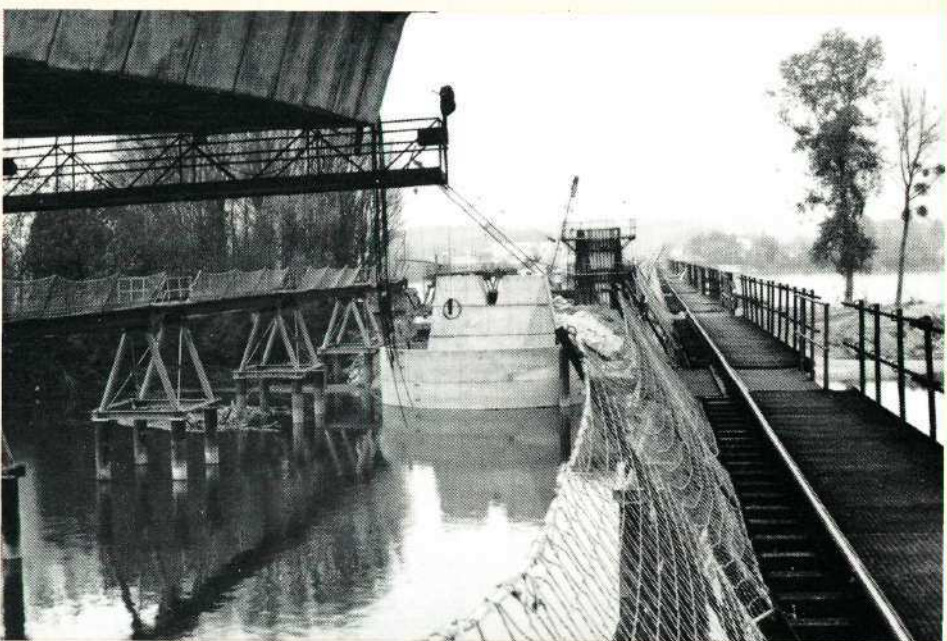
Vue sur une pile avec son batardeau en viroles de béton armé.
