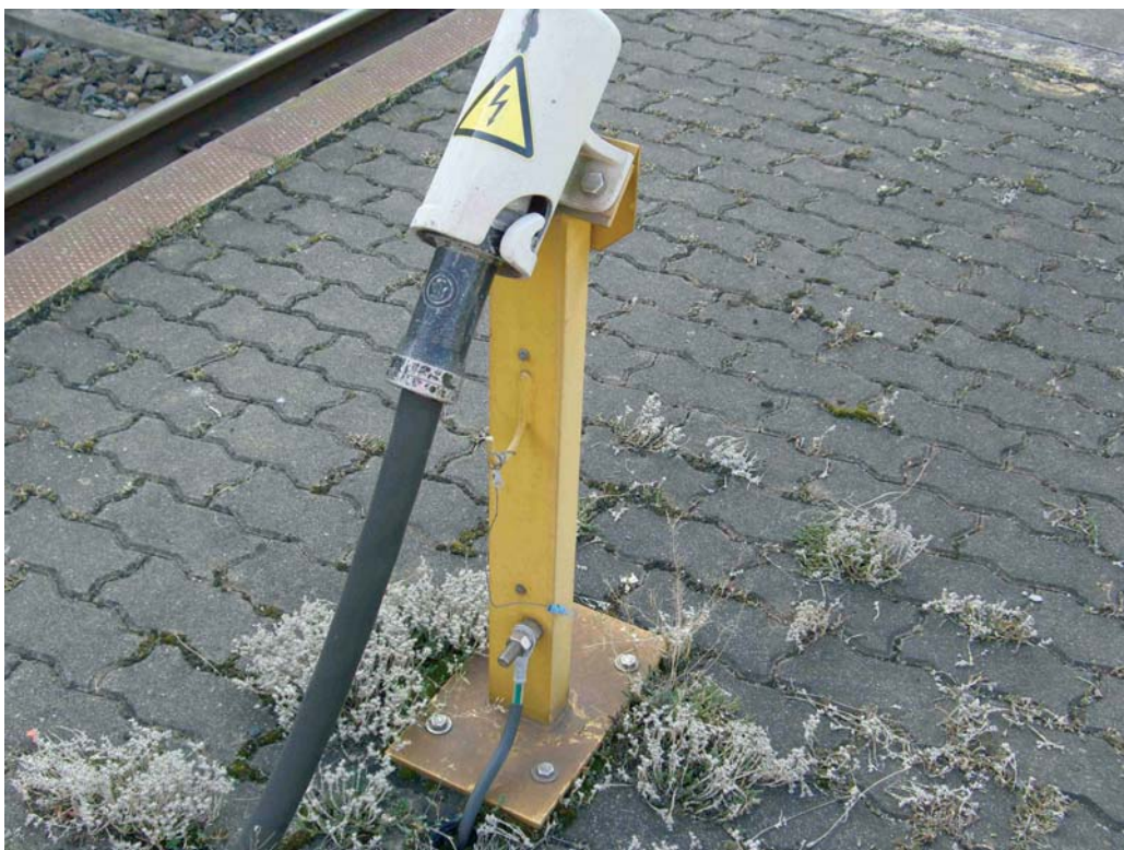
Abbildung 2: Erdung an einer Zugvorheizeinrichtung.
