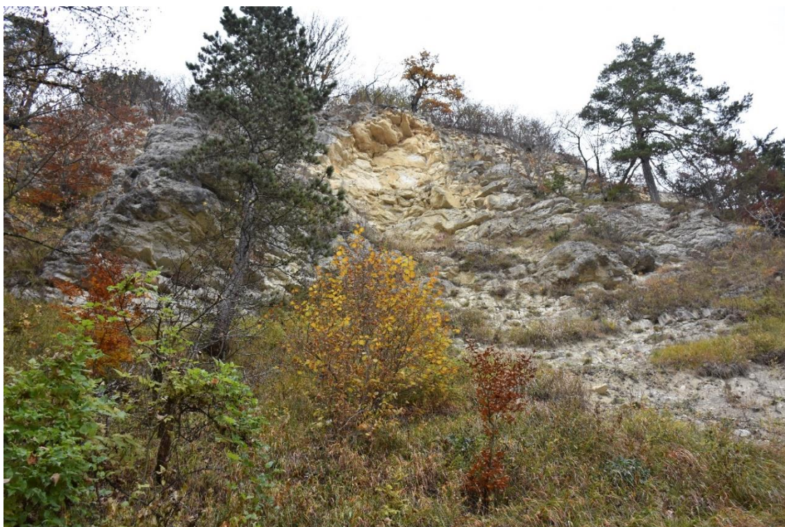
Abb. 4-1: Farbveränderung in der Felswand des Plettenkellers durch rezente Felsstürze: grau: verwitterte Oberfläche, hellbraun: frische Oberfläche, durch rezenten Felssturz sichtbar. Links unterhalb des hellbraunen Bereichs liegt der Aufschluss Keller 1.
