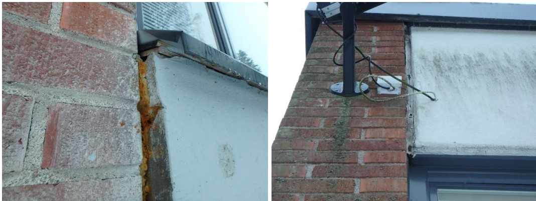
Kuva 16. C-osan idän puoleisella julkisivulla nurkan tiilimuurauksen ja sokkelin sauma oli avoin, ja ikkunan yläpuolinen saumausmassa oli huonokuntoinen.
