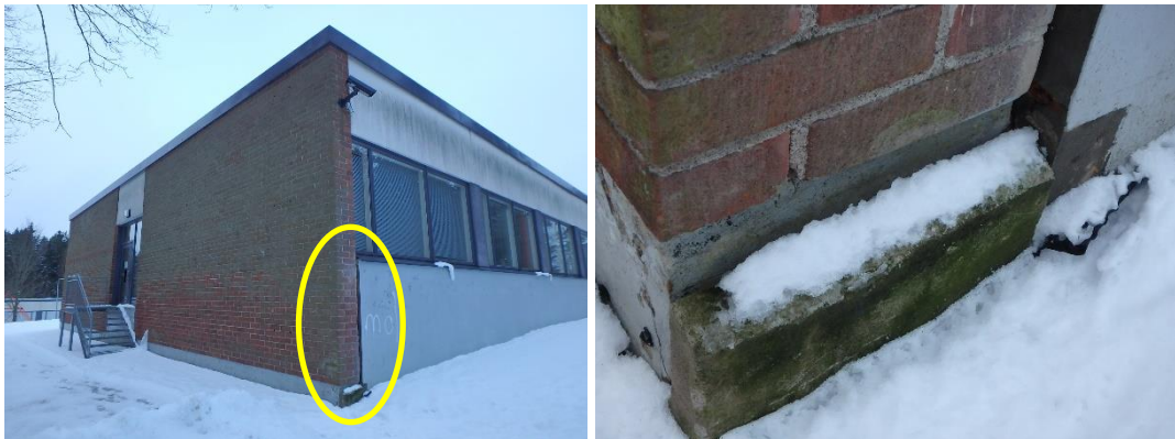
Kuva 15. C-osan eteläpäädyissä kasvoi sammalta ja idän puoleisella nurkalla tiilimuurauksen ja sokkelin sauma oli avoin.
