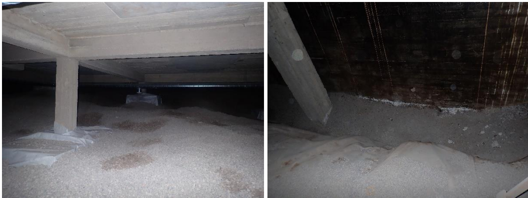
Kuva 9. Alustatilan sepelikerroksen päällä havaittiin paikoin tummempia kohtia. Pilareiden ja kellariseinän alaosissa havaittiin paikoin kalkkihärmettä, mutta ei selvää kosteuden nousua rakenteeseen.
