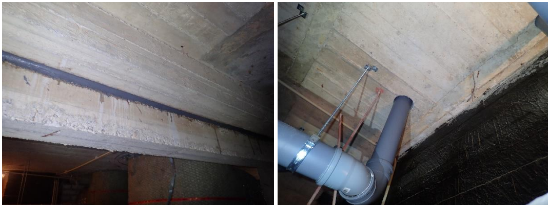
Kuva 11. Alapohjan (liikunta)saumoja oli tiivistetty, mutta viemäriläpiviennit olivat alapuolelta pääsääntöisesti tiivistämättömiä.
