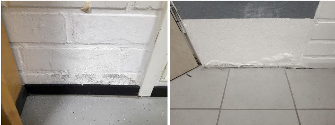
Kuva 29. Käytävän 316 ja luokkien välsiin tiiliväliseinien alaosiin nousee kosteutta. Luokan 329 pilarin alaosan tasoitteesta ja maalista otetussa materiaalinäytteessä ei todettu mikrobikasvustoa.
