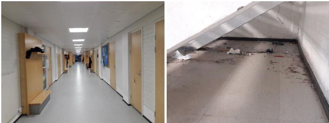
Kuva 3. Yleiskuva käytävältä 316, jossa alapohjan lattiapinnoite on vaihdettu vesihöyryä läpäisevään epoksinnoitteeseen, mutta alapohjaan ei ole lisätty puuttuvaa lämmöneristettä. Alapohjarakenne oli märkä. Vaikeasti siivottavat nurkat ja ylätasopinnot olivat pölyisiä ja likaisia.
