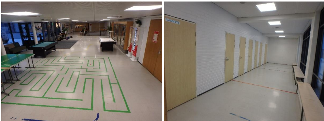
Kuva 4. Sisääntuloaulassa 337 ja wc-aulassa on vanha vinyylilaattapinnoite ja wc-tiloissa muovimatto. WC-aulan vinyylilaatan alapinnassa (RA11) todettiin mikrobikasvustoa ja inva-wc:n 336 muovimatossa (RA15) haihtuvien orgaanisten yhdisteiden pitoisuudet ylittävät Työterveyslaitoksen viitearvot.
