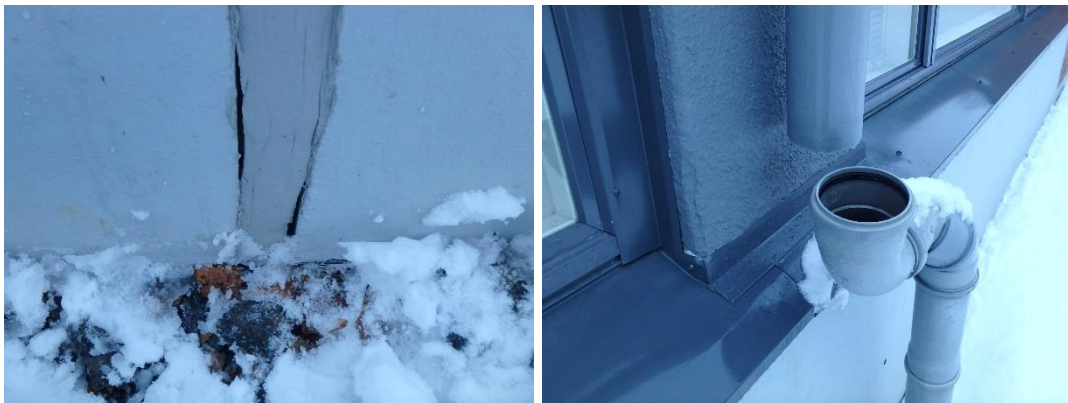
Kuva 17. Rakennuksen julkisivun saumausmassoissa oli halkeamia. Idän puoleisella julkisivulla tuuletusputken liitos oli irti.
