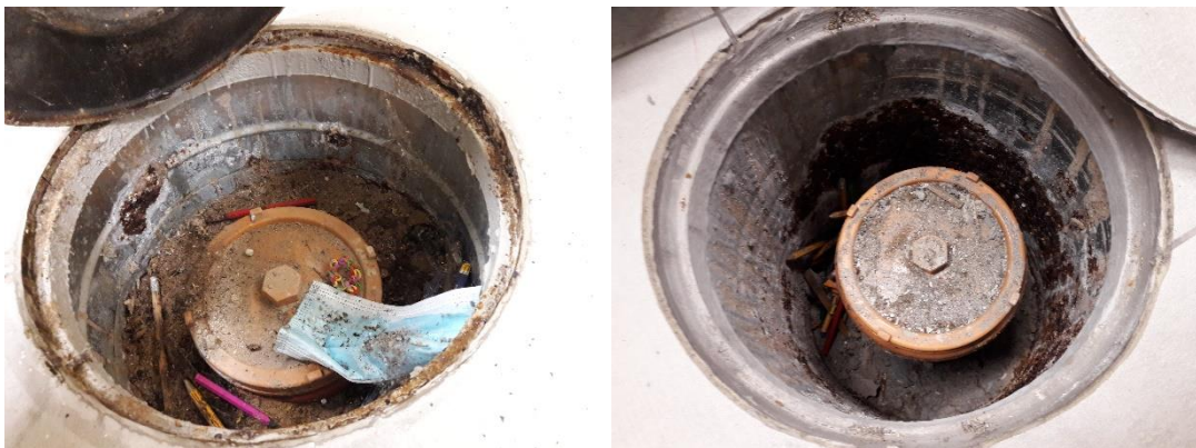
Kuva 6. Käytävällä 316 olevissa viemärikaivoissa aistittiin viemärin hajua. Käytävällä ja luokassa 324 olevat kaivot olivat ruostuneet maakosteuden vaikutuksesta. Kaivojen kansien rei'istä oli työnnetty kaivoihin kyniä, hengityssuojaimia ym tavaraa.
