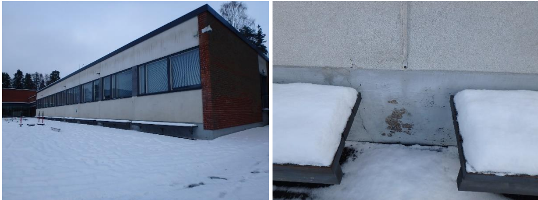
Kuva 14. C-osan julkisivu länteen. Julkisivuissa oli halkeamia ja sokkelien maalipinta hilseili paikoin. Saumoista puuttui tuuletusputkia.
