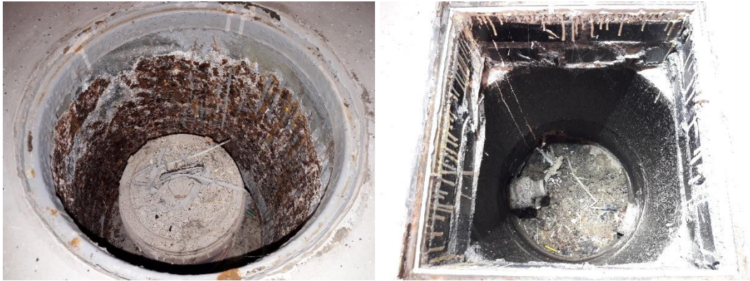
Kuva 7. C-osan aulassa oleva viemärikaivo oli ruostunut maakosteuden vaikutuksesta. B-osan käytävällä 202 oleva salaojien tarkastuskaivon maapohja oli aistinvaraisesti arvioituna kostea, mutta kaivossa ei ollut vettä. Salaojakaivon reunat oli pinnoitettu.
