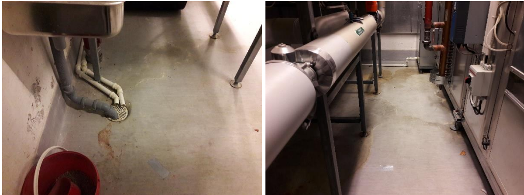
Kuva 5. Ilmanvaihtokonehuoneen 200 muovimaton pinnalla oli kuivuneita vesijälkiä, alapohjarakenne oli sisäänkäynnin ja lattiakaivon ympäriltä kosteusmittausten perusteella märkä. Myös väliseinärakenteessa havaittiin kosteutta sekä maalin ja tasoitteen hilseilyä.
