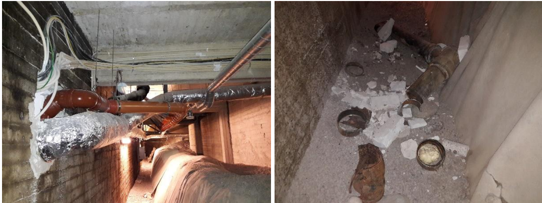
Kuva 10. Hiljattain rikkoutunut viemäriputki oli uusittu, mutta rakennusjätteet alustatilassa oli siivoamatta.
