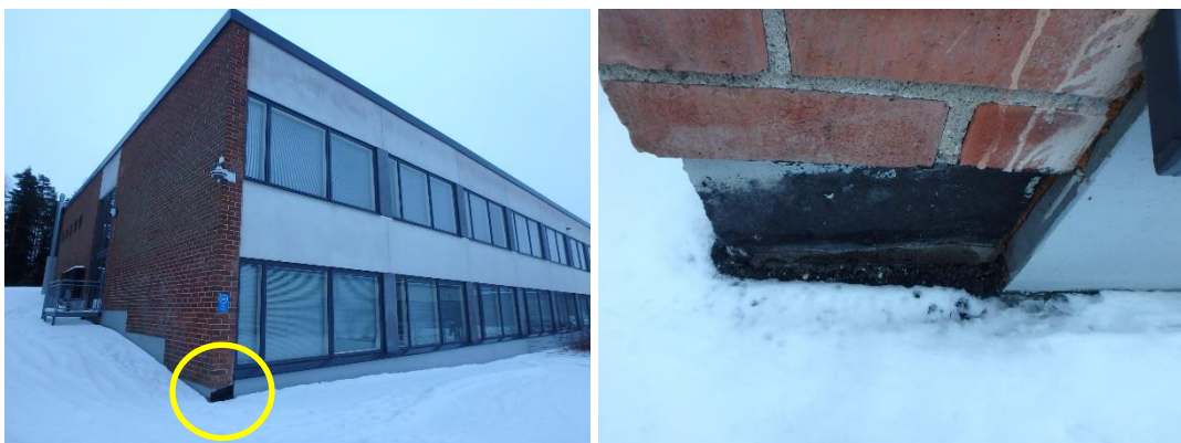
Kuva 18. B-osan pohjoispäädyn ja idän puoleisen julkisivun tiilimuurauksen ja sokkelin sauma oli avoin.
