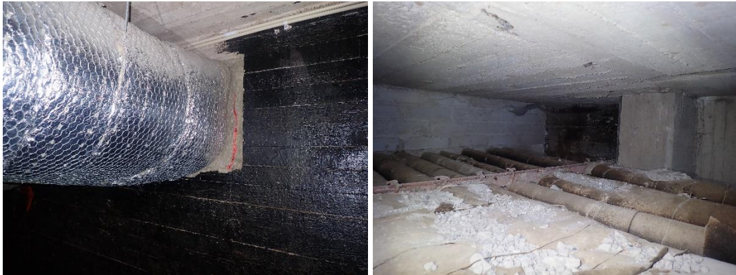
Kuva 12. Ilmanvaihtokonehuoneen ja käytävän vastaisella seinällä oli bitumisively. Ilmanvaihtokonehuoneeseen menevät putket oli tiivistetty mineraalivillalla. Alustatilan toisessa päässä oli runsaasti tervapaperilla ja mineraalivillalla eristettyjä putkia.
