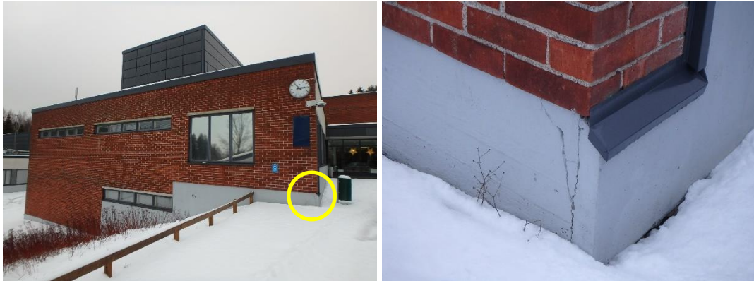
Kuva 19. B-osan eteläpään sokkelissa on halkeama.
