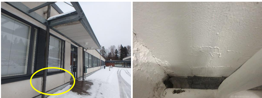
Kuva 21. Tilan 239 ulkoseinärakenteen saumat olivat huonokuntoiset ja sisäkuoren liittymissä oli halkeamia.
