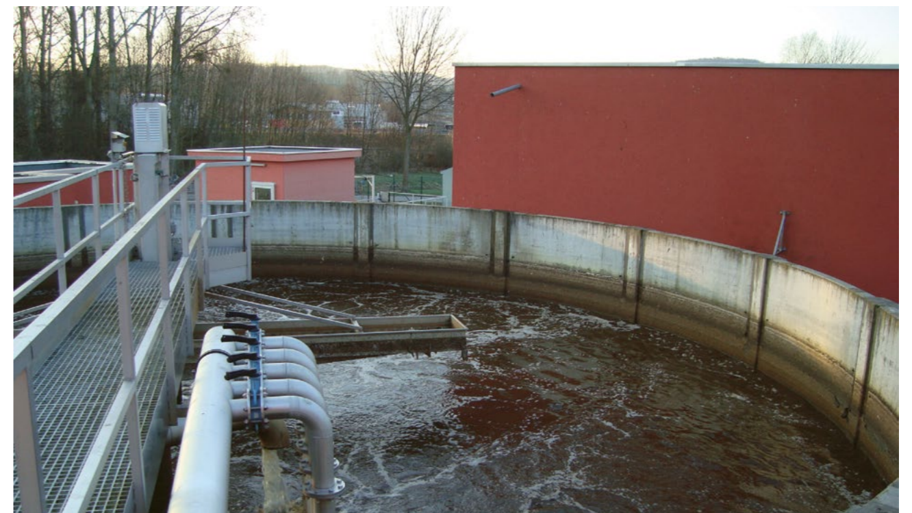
Bassin biologique à boues activées à la STEP d'Avenches
