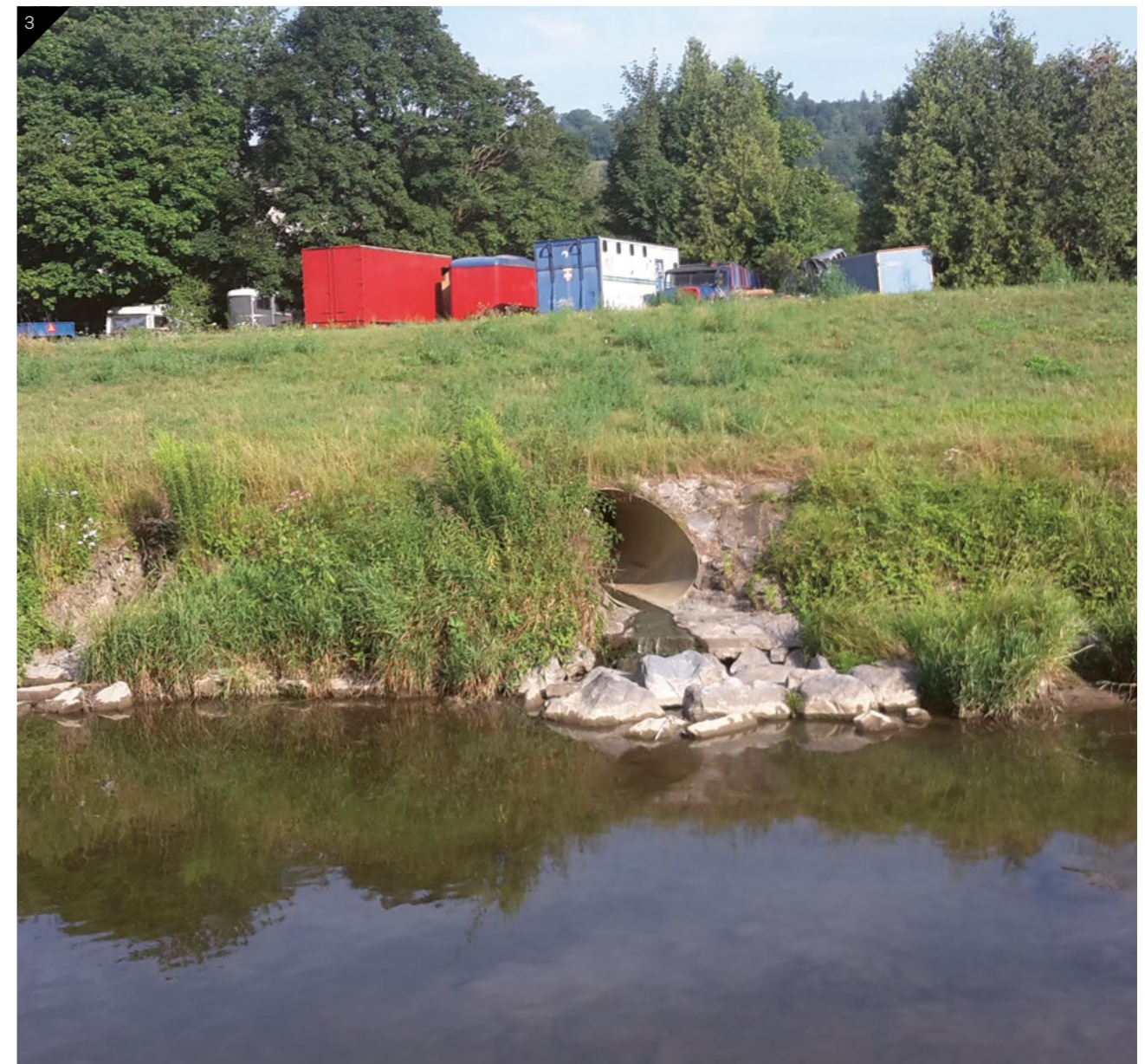
1 - Rejets situés à l'aval de déversoirs d'orage (DO), marqués par l'arrivée régulière d'eaux usées 2 - Travaux d'aménagement de collecteurs d'évacuation des eaux 3 - Rejet d'eaux de ruissellement
