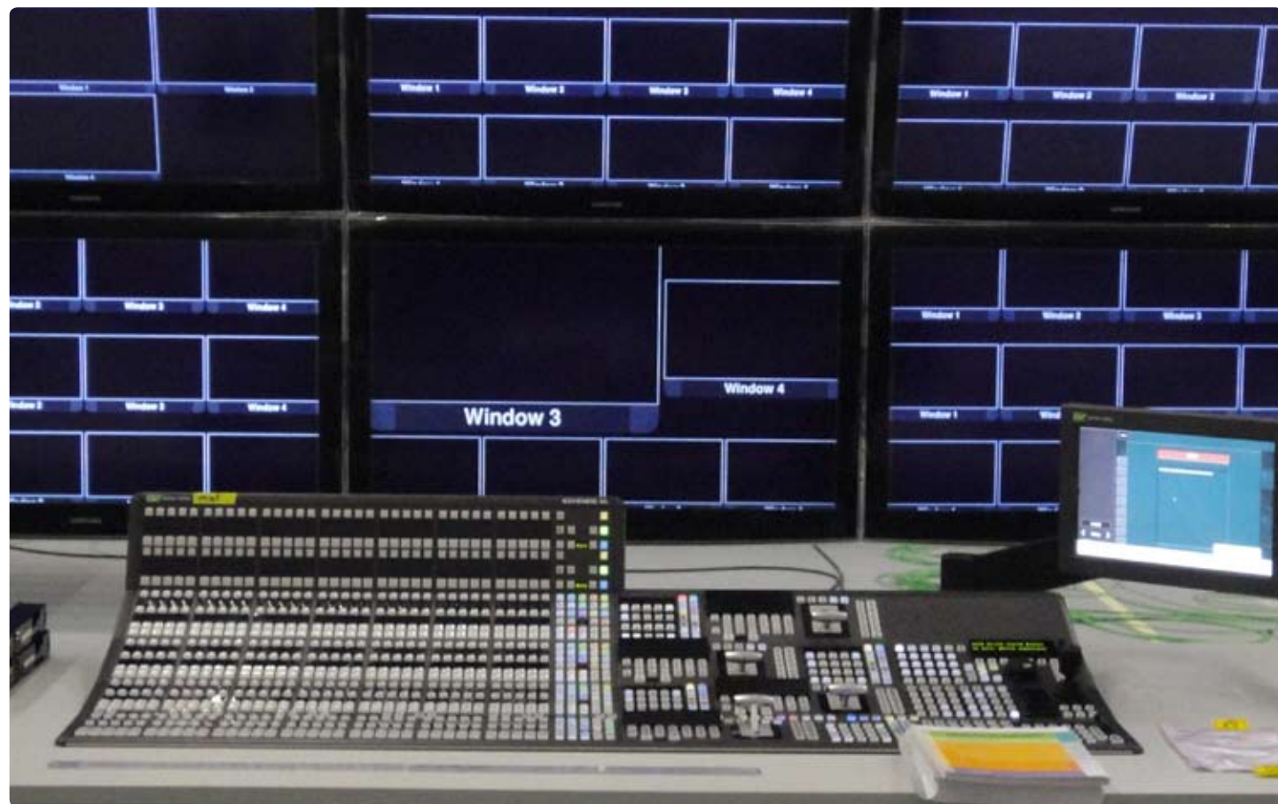
Testaufbau im Studio Berlin Adlershof. Die Axon Quad Splitter wurden kaskadiert und für eine Wiedergabe auf bis zu 16 Bildern pro Monitor zusammengeschaltet.
