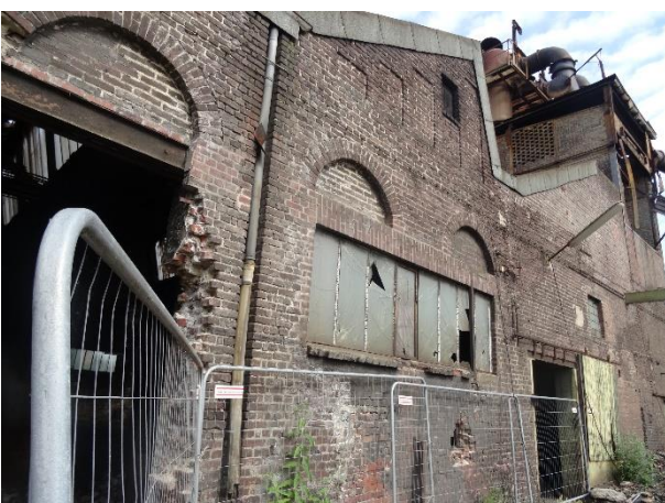
Abbildung 7: beschädigte Fenster der Eisengießerei, Quelle: ISR 2019
