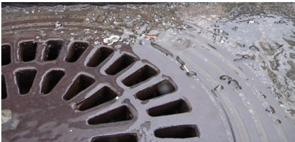
Kuva 29. Tyypillinen puhdas sadevesikaivon ritiläkansi
