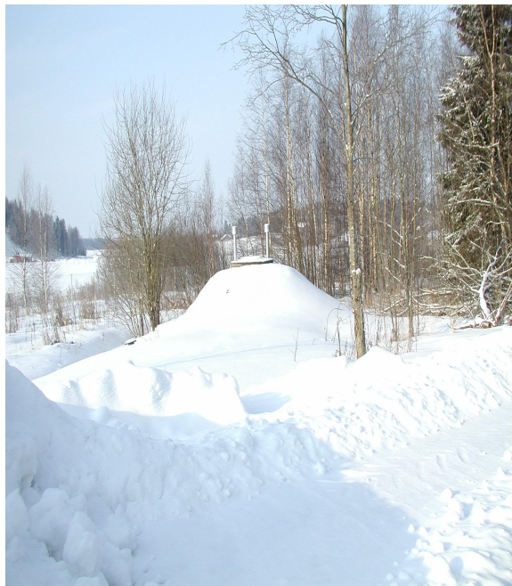
Kuva 9. Isolähteen yhden siiviläputkikaivon maanpäällinen osa
