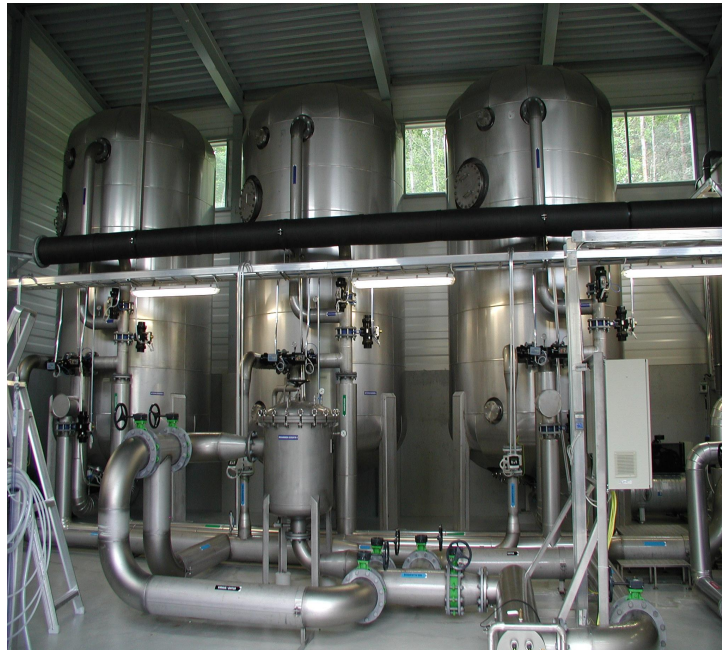
Kuva 7. Luontolan vedenottamon aktiivihiilisuodattimet
