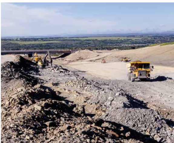
Réalisation des travaux de contournement de Calgary, au Canada. Cette infrastructure routière comprendra quatre échangeurs, sept ponts, ainsi qu'un passage souterrain pour les piétons.
