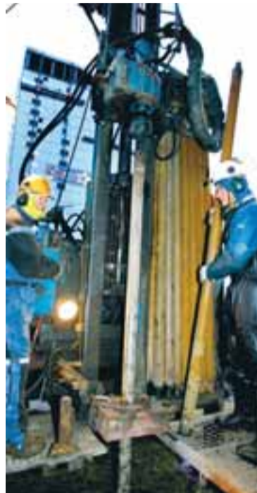
Ástþór Atli Haraldsson og Árni Kópsson bora fyrir undirstöðum fyrir brú yfir Fífuhvamsveg við Smáralind.
