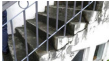
Skemmdir við Hringbraut og Landakot.
