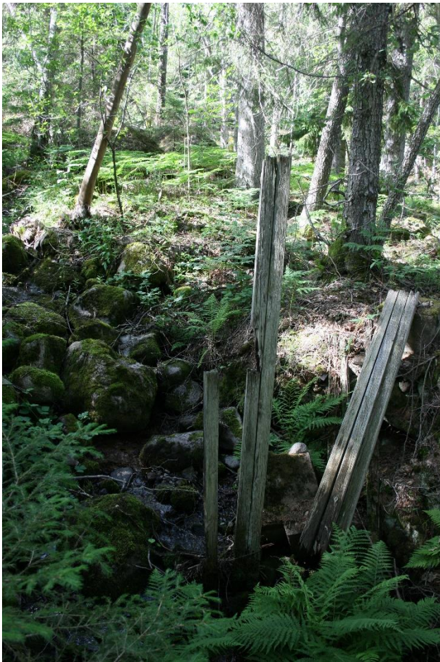
Figur 38. Rester av dammanläggning vid grävd kanal längs Virån.
