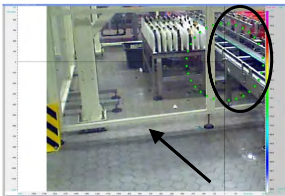
Abbildung 91: Spalt (Pfeil) und Öffnung (Ellipse) in der Schallschutzverkleidung einer Sortieranlage
