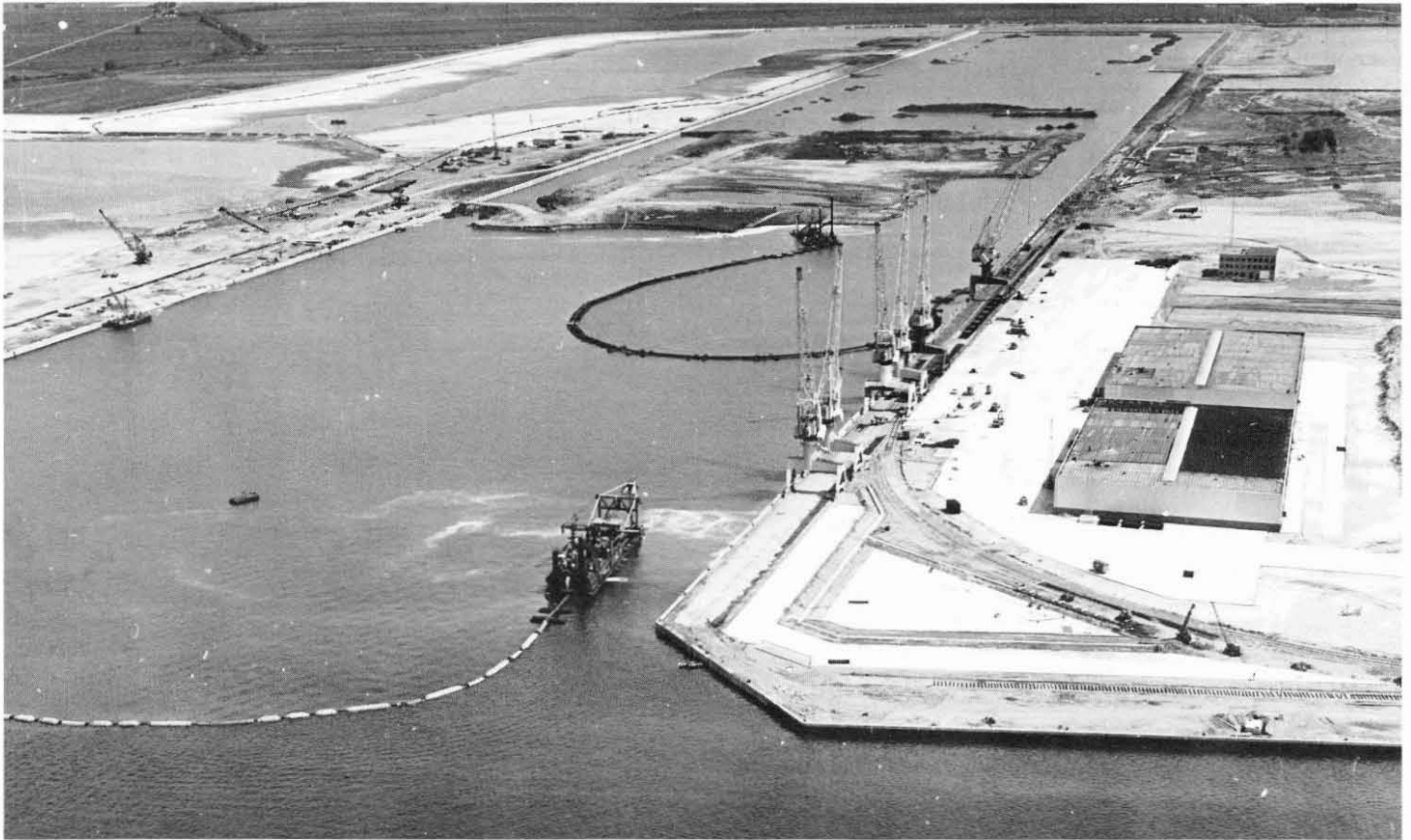
Figuur 5 : Uitbaggeren van het dok met twee cutterzuigers en hydraulische ophoging van de kaaivlakten rond het dok.
