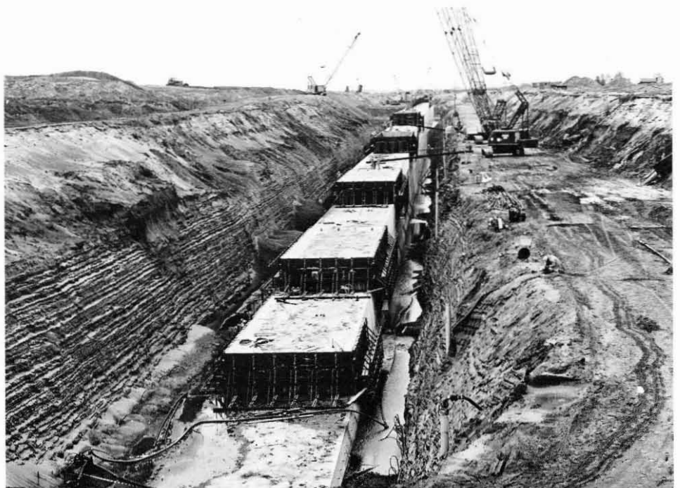
Figuur 3 : Opbouw van de massieve kaaimuur tijdens de eerste fase. In een bestendig drooggehouden bouwsleuf wordt de muur opgetrokken in moten van 20 m lengte en 2,70 m hoogte.
