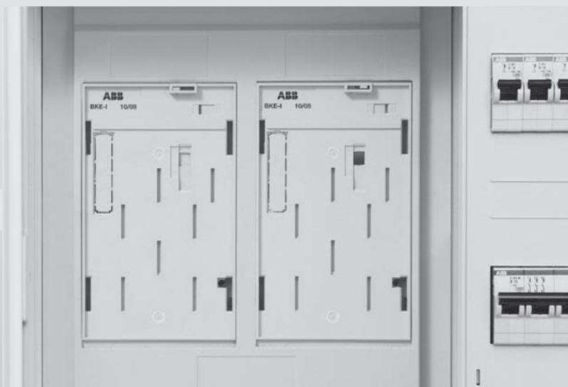
Im neuen Zählerplatz ist die BKE-I (Befestigungs- und Kontaktiereinrichtung) für den elektronischen Haushaltszähler integriert.
