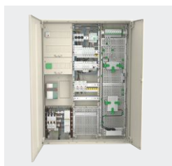
7 Zählerplatz und Verteilersysteme z. B. Zählerschrank mit Acti9 und Mediafeld
