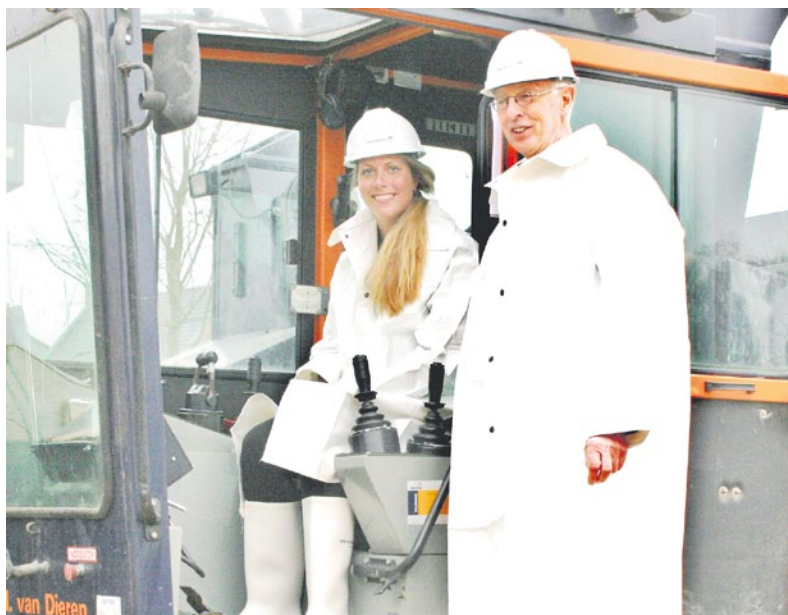
Toekomstig Schaekerhof bewoonster, Ilona Draaier, mocht onder het toezicht van wethouder J. v/d Muyden de enorme heilmachine bedienen om de "eerste paal" de grond in te slaan.
