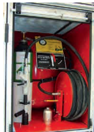
Feuerlöschcontainer von vorne
