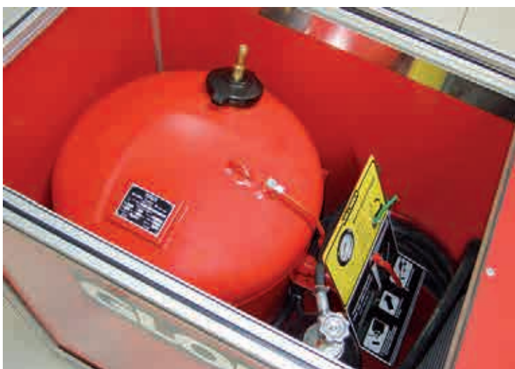
Feuerlöschcontainer von oben
