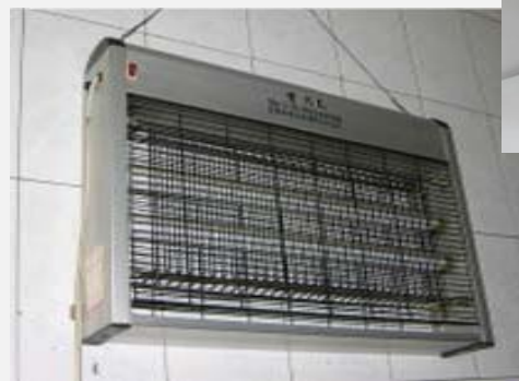
不合理的安装方式（应安装高度 1.5-2m，离墙30cm）
