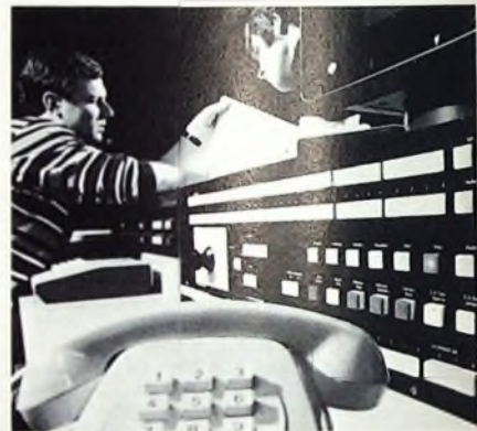
Über den Bedienungsplatz und die angeschlossenen Datenterminals hat das Bedienungspersonal unmittelbaren Zugriff zum Zentralsteuerwerk des „EWS 1“. Bei Inbetriebnahme der Vermittlungsstelle dient der Bedienungsplatz beispielsweise zum Laden der Speicher mit Programmen und Daten
